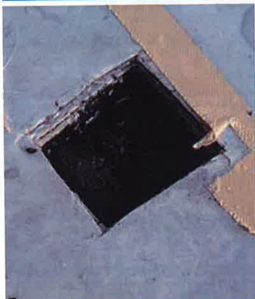
アスファルト防水層内に水が溜まっている
